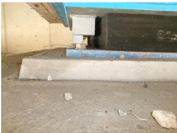
신기교 교량받침 A1-SH8 무수축몰탈 균열 0.1/0.1
