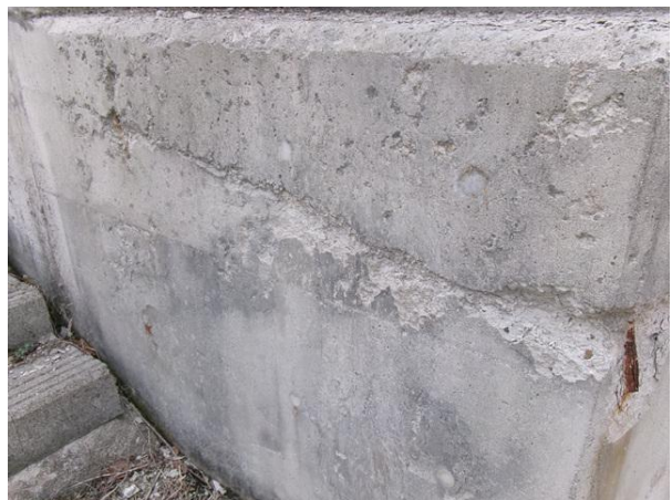
신기교 교대 A1 구체 좌측면 콘크리트 박리 0.2*1.5
