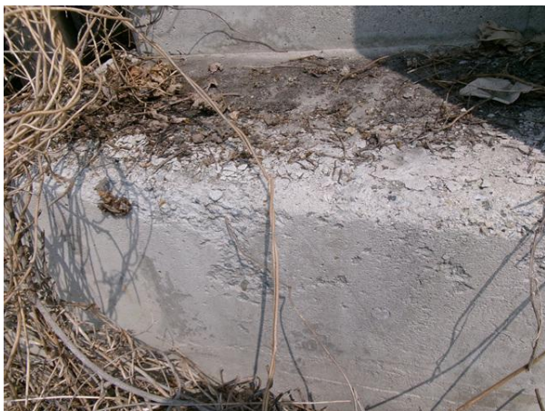
신기교 교대 A1 구체 우측면 콘크리트 박리 0.2*0.6
