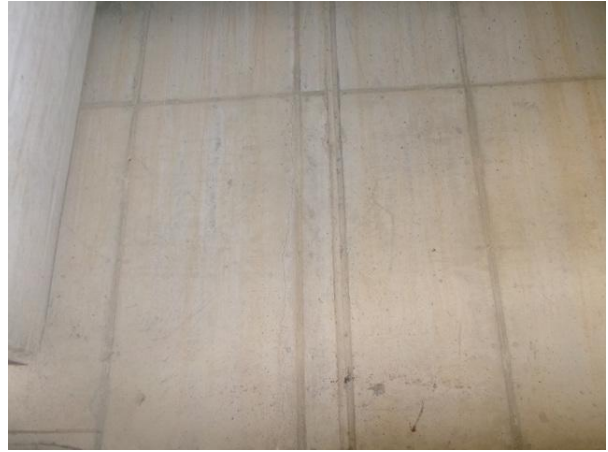
신기교 교대 A2 균열 0.2/2.0 -신규-
