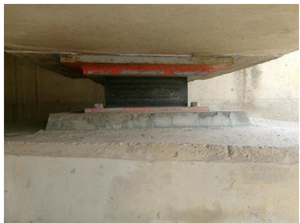
신기교 교량받침 A2-SH10 무수축몰탈 박락 0.2*0.5 -신규-
