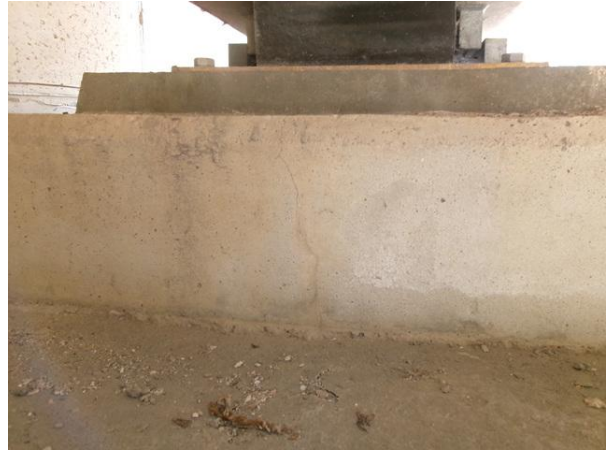
신기교 교량받침 A1-SH1 받침콘크리트 균열 0.1/0.2
