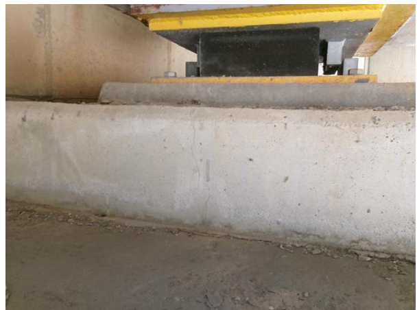
신기교 교량받침 A1-SH2 받침콘크리트 균열 0.1/0.2
