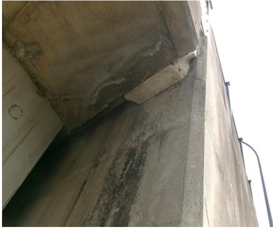
신기교 교대 A1 흉벽 콘크리트 박리 0.3*0.3
