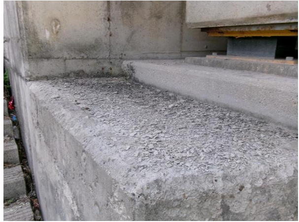
신기교 교대 A1 구체 상면 콘크리트 박리 1.52*0.5
