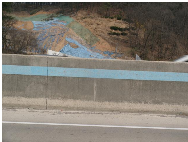
신기교 이천방향 방호벽 S1 중분대 균열 0.3/1.0_신규
