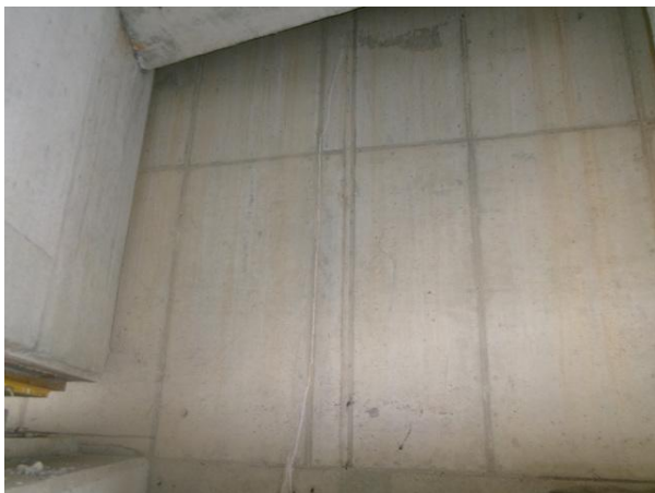
신기교 교대 A2 균열 0.2/2.0 -신규-
