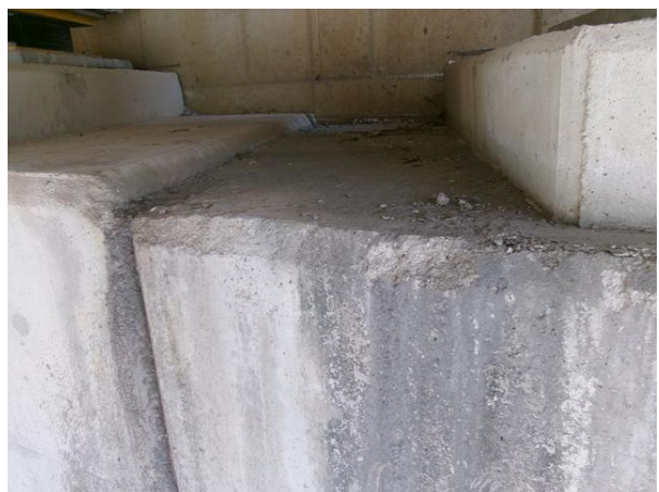
신기교 교대 A1 구체 콘크리트 박리 0.1*0.8
