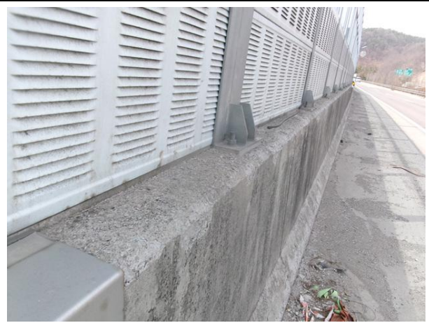
신기교 이천방향 방호벽 S1 박리(열화) 1.2*40.0_신규
