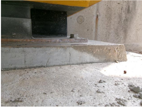
신기교 교량받침 A1-SH1 무수축몰탈 균열 0.1/0.1
