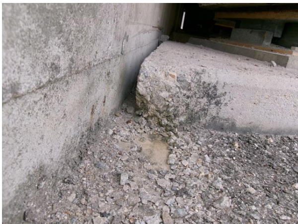
신기교 교량받침 A1-SH10 받침콘크리트 박리 0.2*0.2
