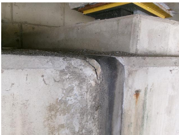
신기교 교대 A1 구체 콘크리트 들뜸 0.1*0.1
